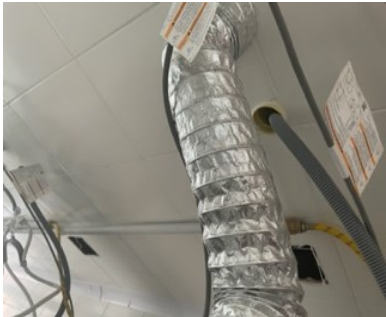
Foto. 7 Falta de rejilla
