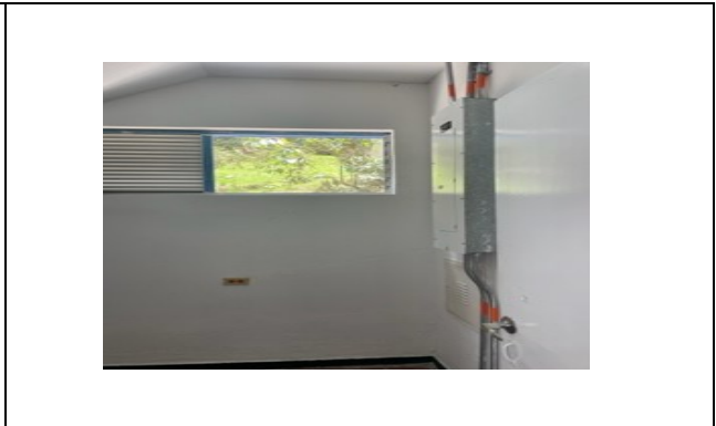
Foto. 12 Cintas de protección sin retirar
