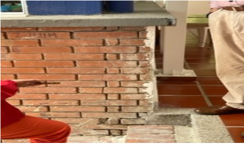
Foto. 3 Humedad exterior oficinas SLIS
