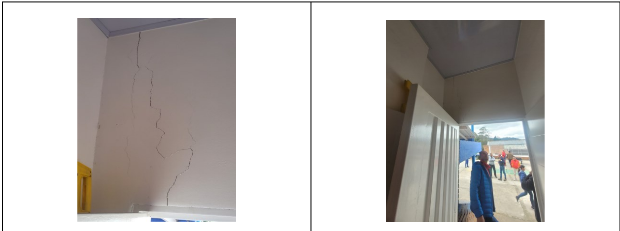
Foto 8 y 9: Fisuras en baño exterior, registro fotográfico del día 2 de agosto de 2023
