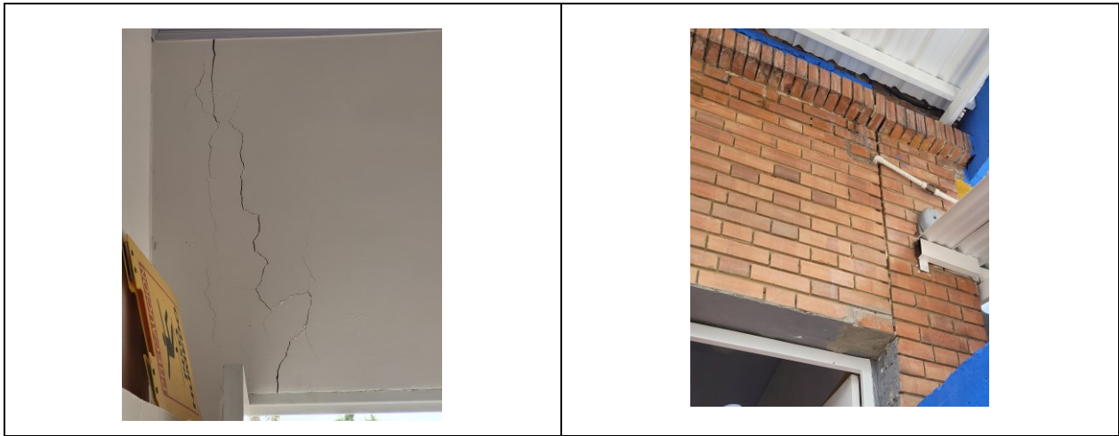
Foto 10 y 11: Fisuras en baño exterior, no se ha realizado intervención a visita del 29 de septiembre de 2023.
