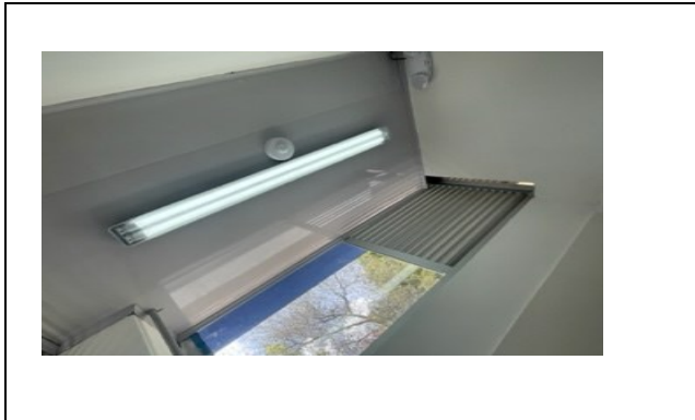
Foto. 17 Espacios entre la pared y ventana
