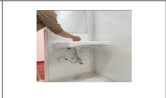
Foto. 18 Inadecuada instalación eléctrica
