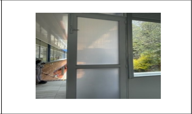
Foto. 10 Bordes irregulares y lámina sin fijar
