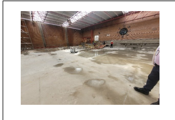
Foto 3 Dotación que no corresponde a la establecida
