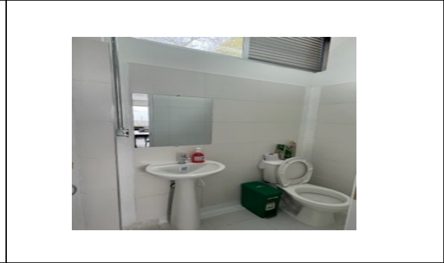
Foto. 16 Inadecuado espacio en la ventana
