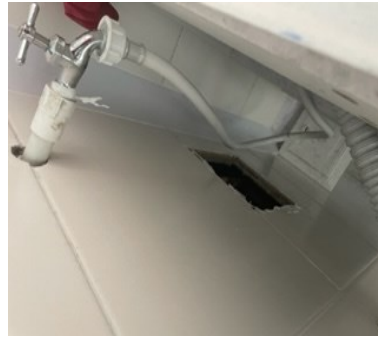
Foto. 6 Ausencia de rejilla
