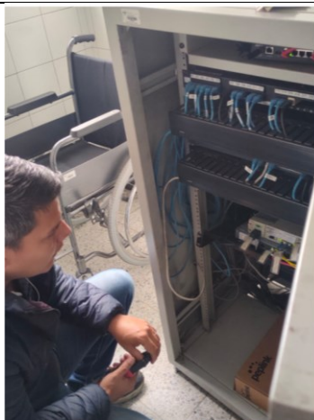
RACK DE COMUNICACIONES ETB en el primer piso de la oficina de salud.
