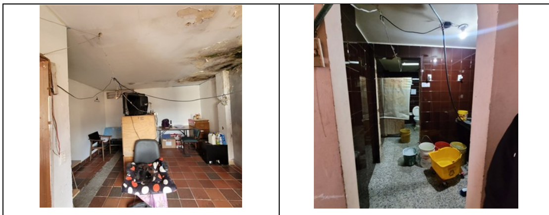
Cuadro 13 Registro fotográfico red eléctrica
