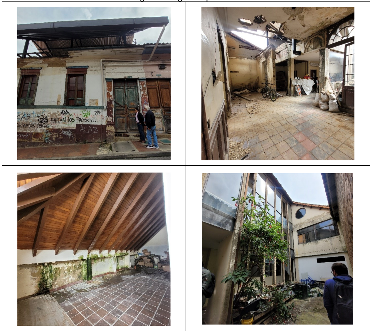
Cuadro 9: registro fotografico predio “La Casona”
